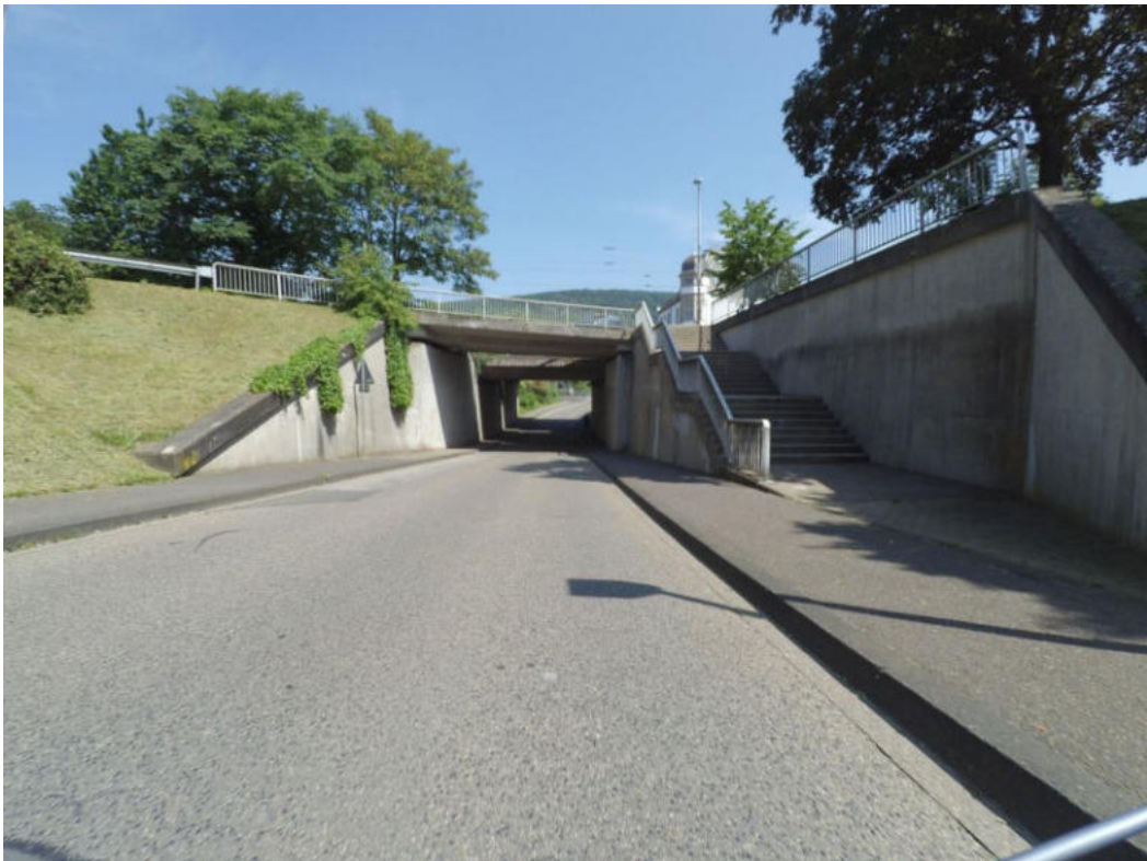
Abbildung 2 Fehlende Beleuchtung im Unterführungsbauwerk
