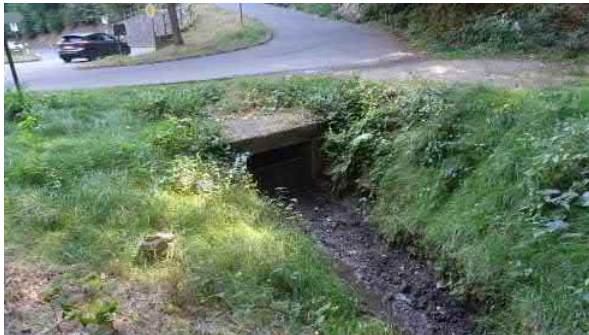
Einlauf im Bereich der L209
