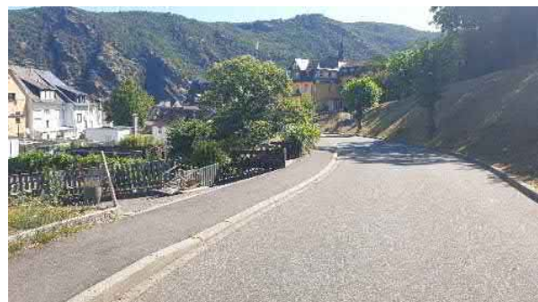
Durch die abgesenkten Bordsteine besteht die Gefahr des Wasserübertritts in die privaten Zufahrten und damit in die Gebäude
