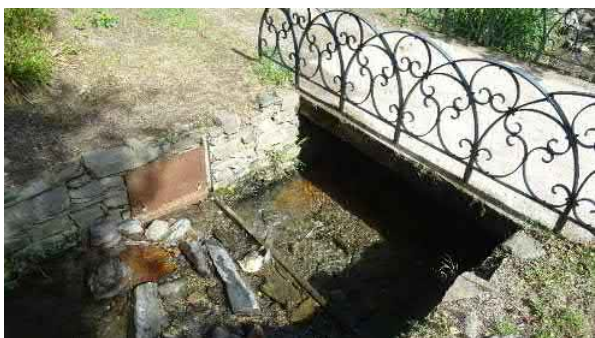
Gering dimensionierter Brückendurchlass
