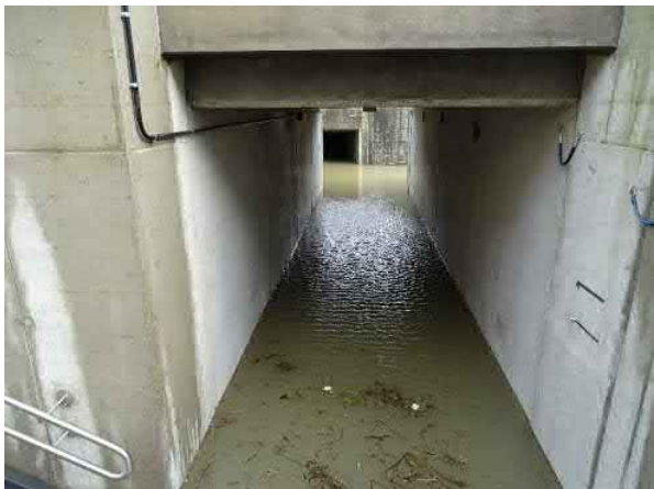
Foto 06: Überflutete Fußgängerunterführung (Feb. 2021)
