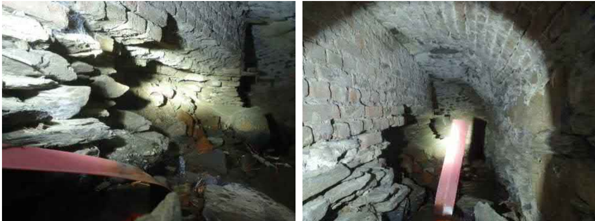
Fotos aus dem Gutachten des Ing.-Büros geo-consult Pohl vom 28.06.2021 – Es bestehen Auskolkungen im Ziegel- bzw. Natursteinmauerwerk
