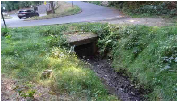
Einlauf im Bereich der L209
