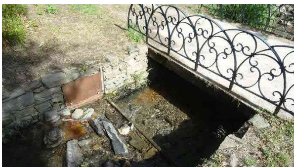
Gering dimensionierter Brückendurchlass
