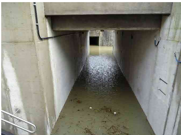
Foto 06: Überflutete Fußgängerunterführung (Feb. 2021)
