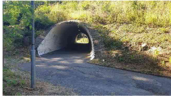
Abfluss Unterführung Marienbergpark
