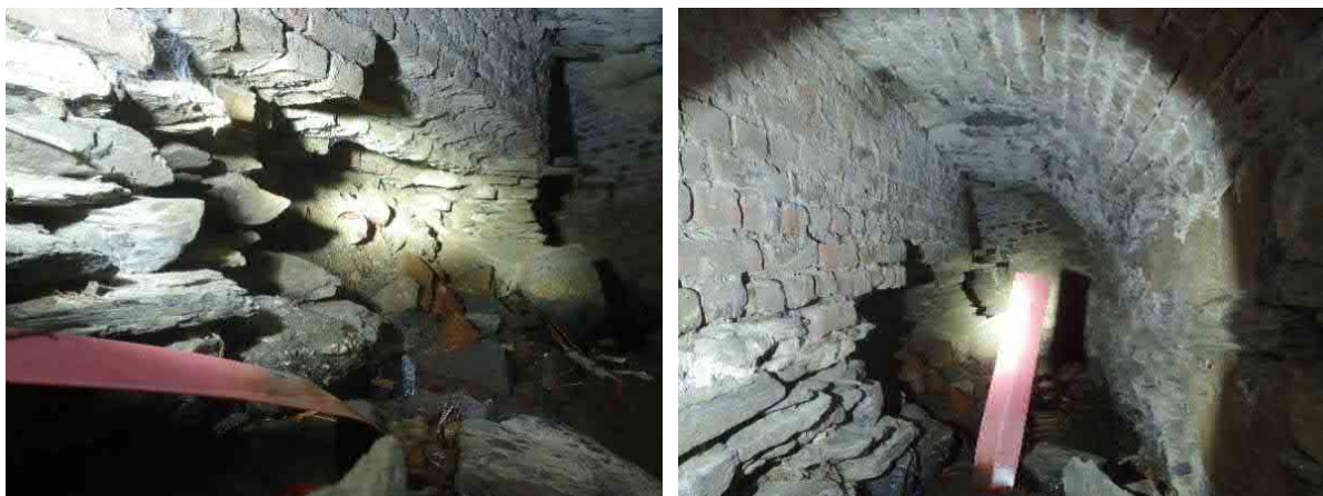
Fotos aus dem Gutachten des Ing.-Büros geo-consult Pohl vom 28.06.2021 – Es bestehen Auskolkungen im Ziegel- bzw. Natursteinmauerwerk
