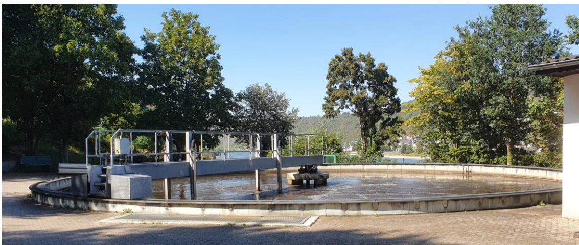
Abb. 5: Belebungsbecken mit umlaufender Belüfterbrücke
